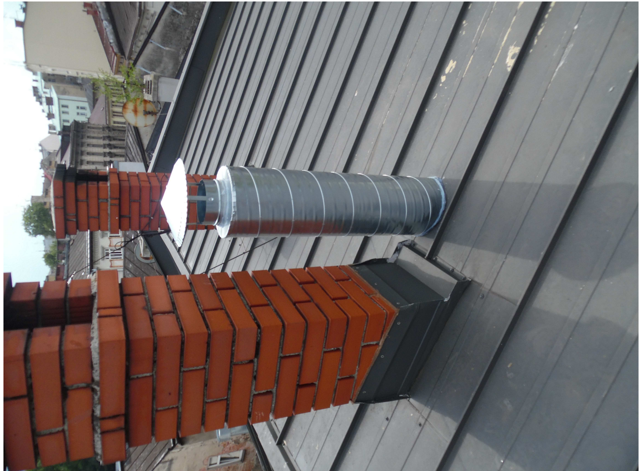
Wykonanie dodatkowego przewodu wentylacyjnego z mieszkania z wyprowadzeniem ponad dach – ulica Zamkowa 24
